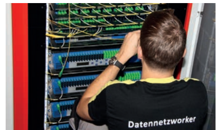
Datenverarbeitungszentrale als Headend oder POP
