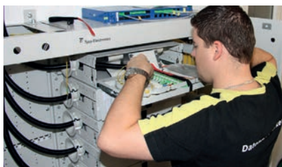
Installation und Inbetriebnahme von optischen Netzwerken
